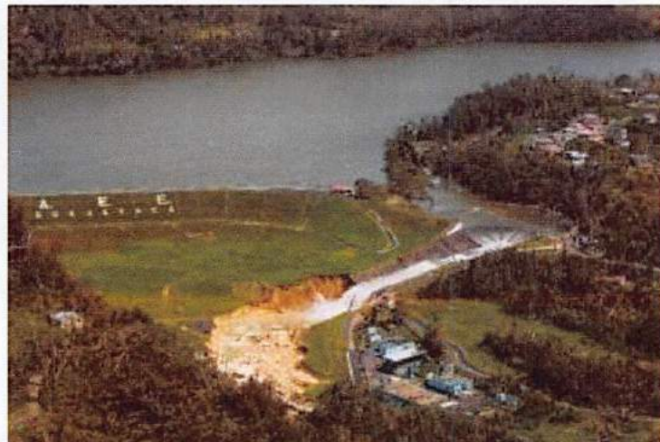
Rotura de Represa Guajataca por Huracán María 2017
