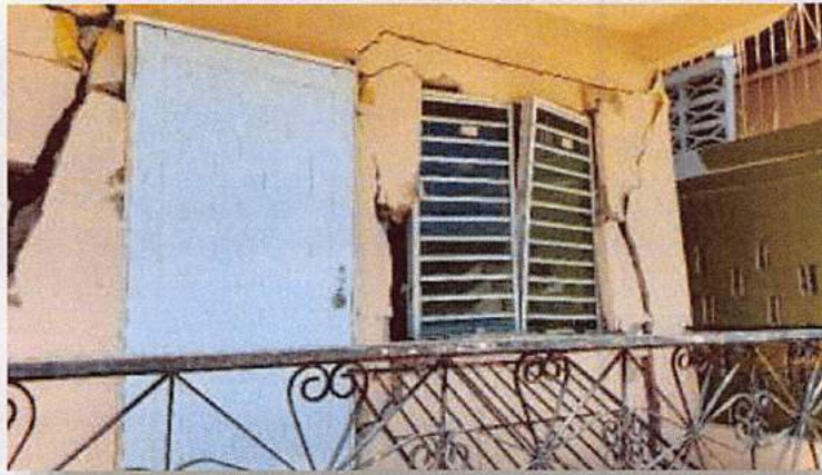
El terremoto causó que puertas y ventanas se descuadraran y por lo tanto quedaron bloqueadas o se salieron de sus marcos
